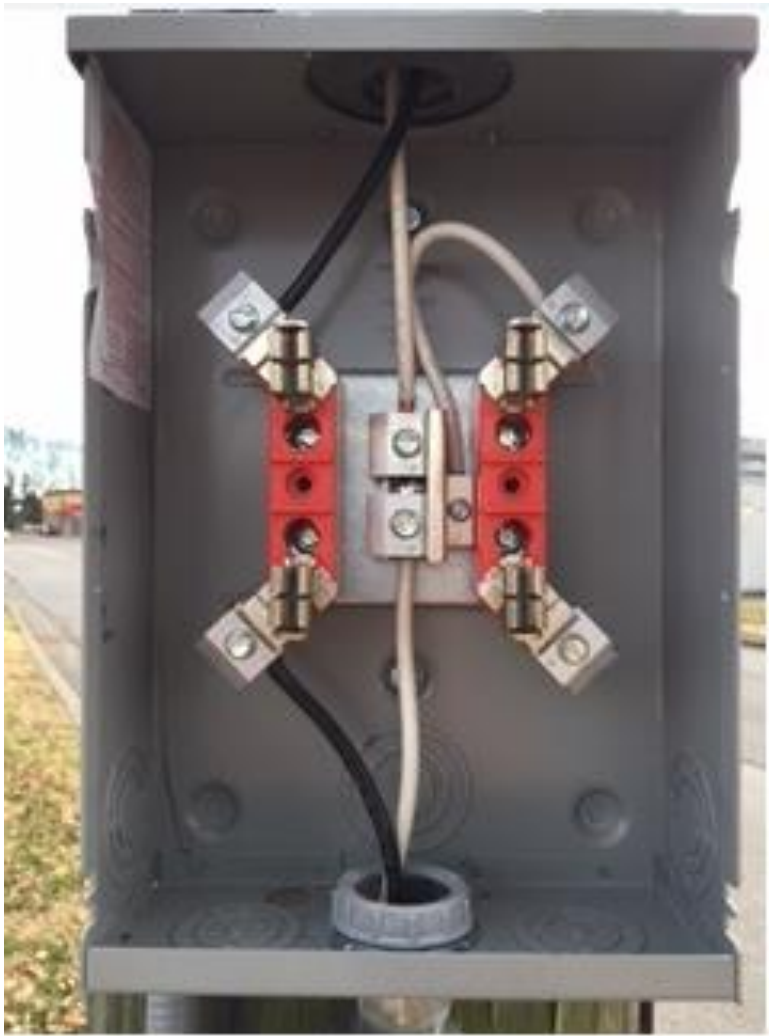
120V Meter Base Wiring
